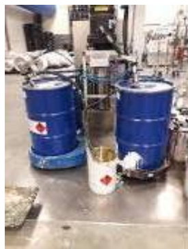
Photo n°3 : Poste de pompage de futs
